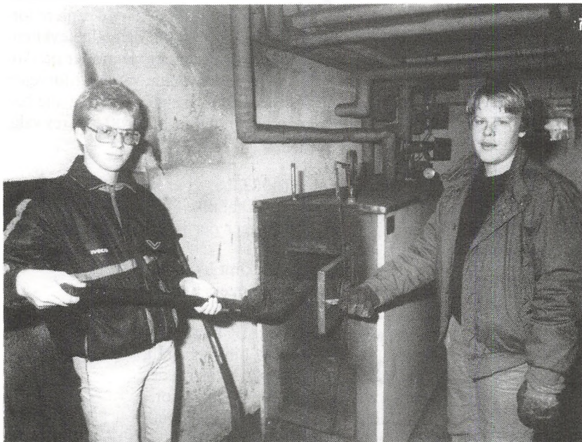
Vi har fjernet denne kedel - og dermed forbedret luften.
